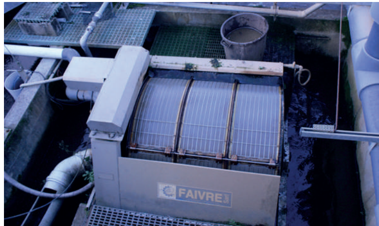
A l'Esturgionnière, en haut : Cuves de filtration biologique Ci-dessus : filtre mécanique
