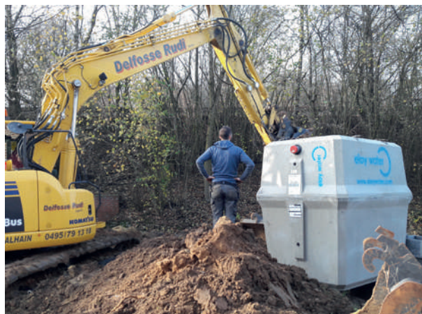
Ci-dessus : Installation d'une microstation Oxyfix® ©Eloy Water ( www.elaywater.fr )
