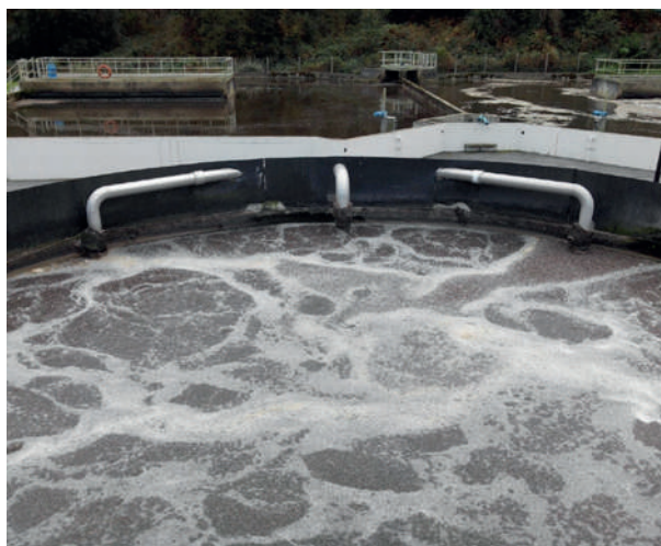
Figure 27 Bassin R3F - STEP de Quéven
