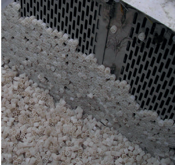
Ci-dessus : Grille plane partiellement colmatée © D.R.
